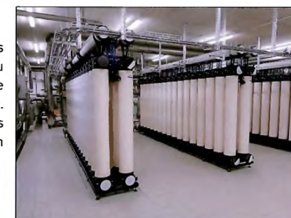
Modules d'ultrafiltration, station de traitement des Avants
